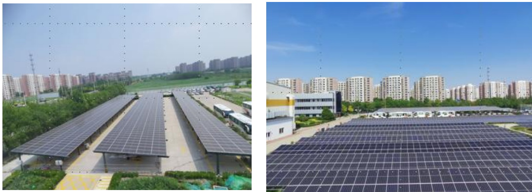
图 6 厂区内分布式光伏项目
